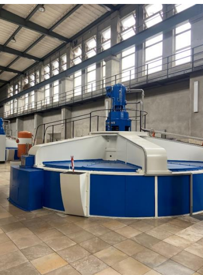
Generatoren der darunterliegenden Turbinen
